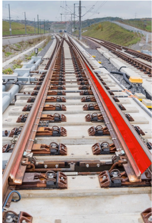
Abbildung 2: An Weichen besteht auch Quetschgefahr
