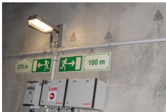
Abbildung 50: Fluchtwegkennzeichnung unter Notbeleuchtung
