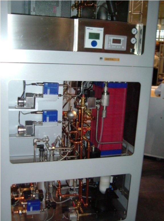
Bild 3: Hausenergieversorgung mit Brennstoffzelle
