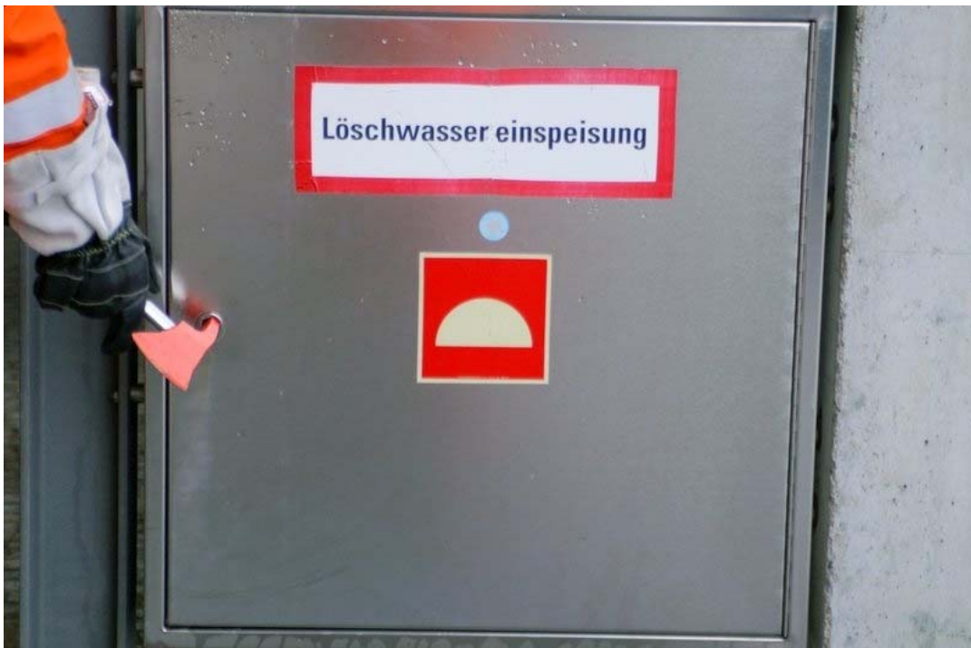
Einspeiseeinrichtung DIN 14461-2 für Löschwasseranlage (Steigleitung) „trocken“
