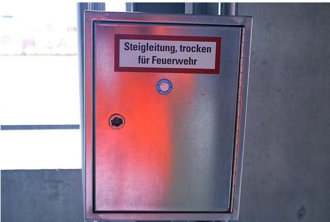
Entnahmeeinrichtung DIN 14461-2 für Löschwasseranlage (Steigleitung) „trocken“ Zukünftige Beschriftung: „Löschwasserleitung, trocken für Feuerwehr“
